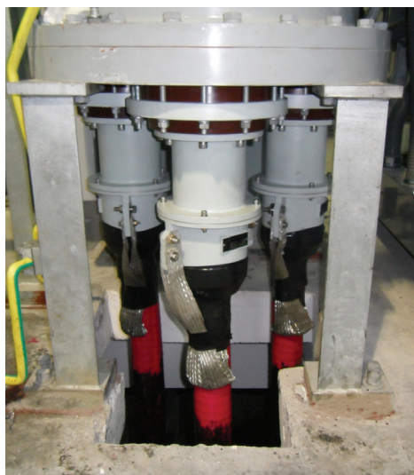
Terminales SSC140-SF instaladas en un GIS.
