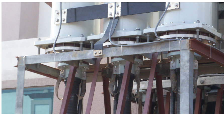
Terminales PATR140-SF instaladas en un GIS.
