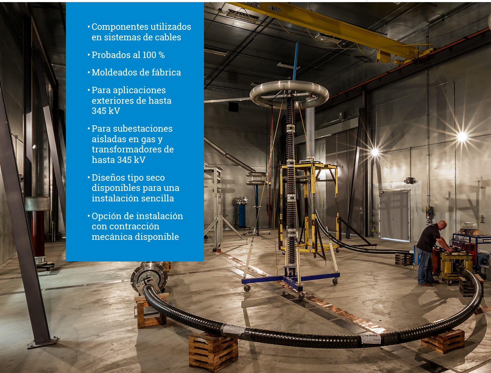
Laboratorio de pruebas de alta tensión de G&W Electric en Bolingbrook, IL
