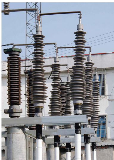
Terminação externa do tipo seco em uma aplicação de subestação.
