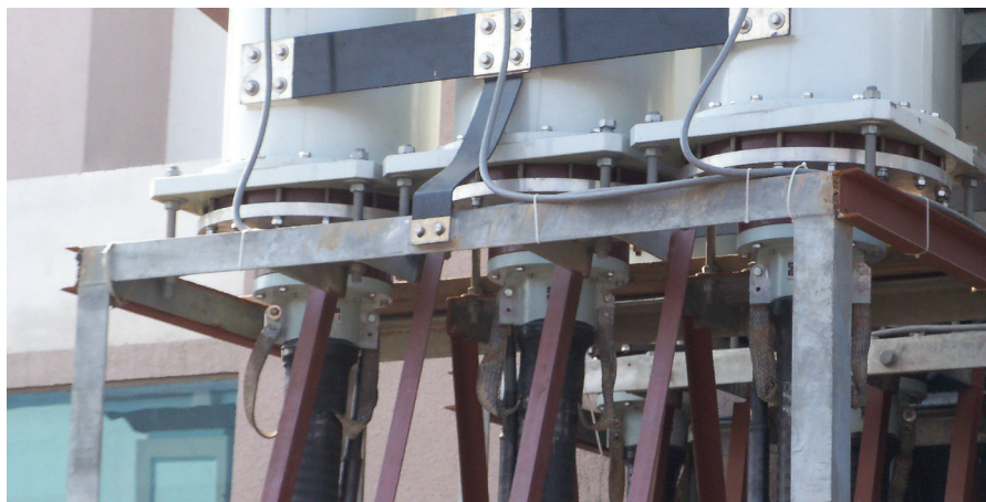
Terminações PATR140-SF instaladas em um GIS.
